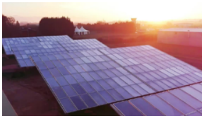
Exemple d'une installation solaire thermique à Merville (59) pour chauffer l'eau de lavage de citernes de transport. Source : rev3-entreprises.fr
